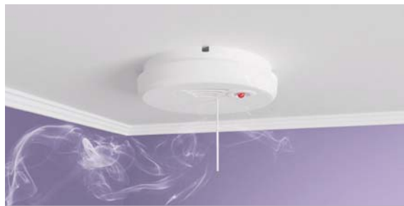
3.Rilevatore Fumo e Fuoco
